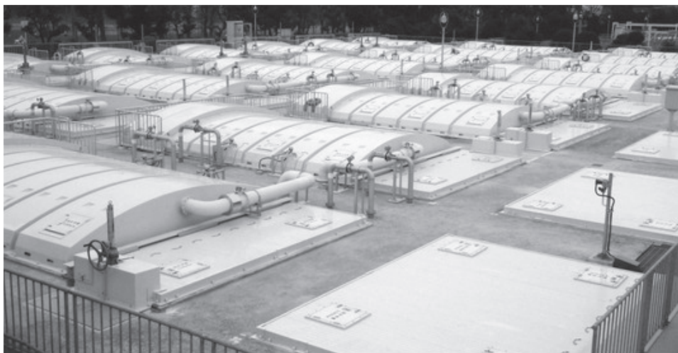
当社施工による耐蝕FRP浄水施設
