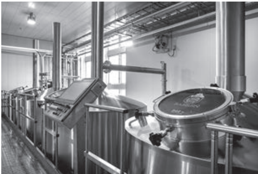
新設した雫石工場のビール醸造設備
